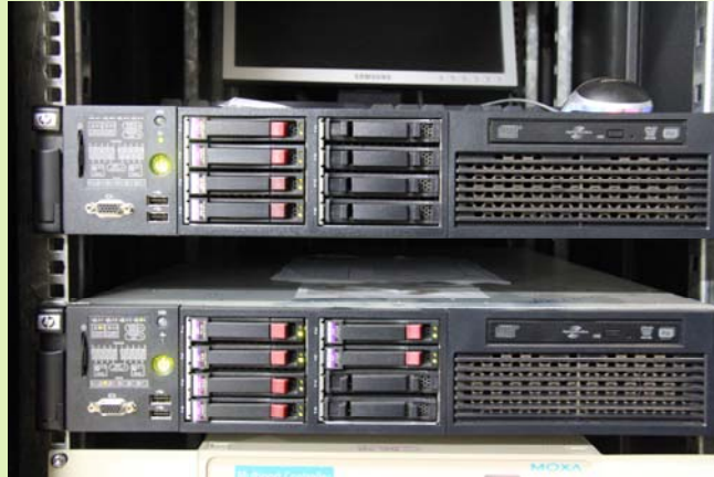
۶ - آماده سازی اتاق سرور شماره ۲
